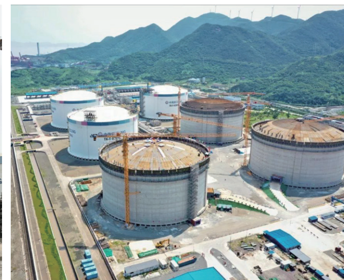
浙江LNG接收站二期项目(3*16万m 3 )
